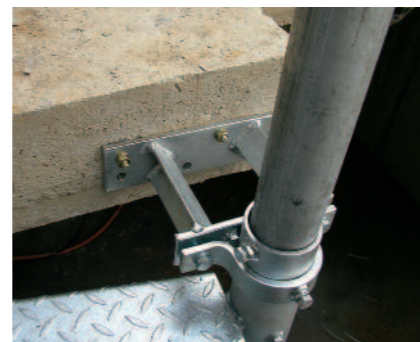
Spindelrohr mit Distanzhalter an der Deckenkante
